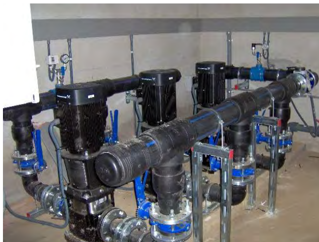
Bombes d'impulsió de l'estació de Puig d'en Roca
