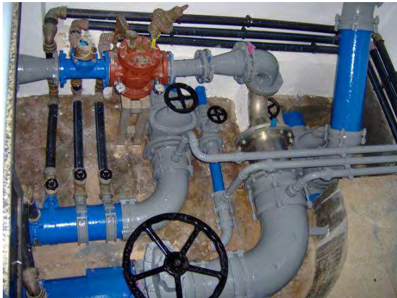
Conjunt de vàlvules del By-pass
