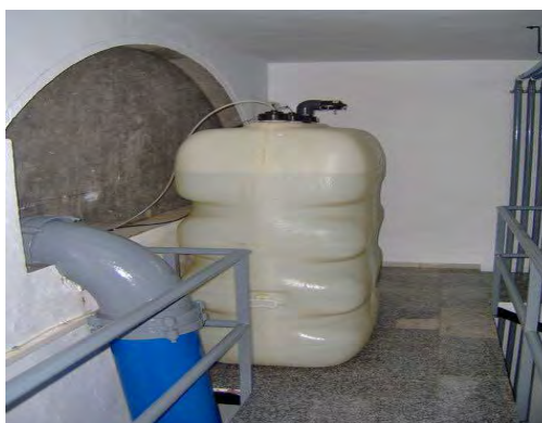
Dipòsit de Hipoclorit Sòdic
