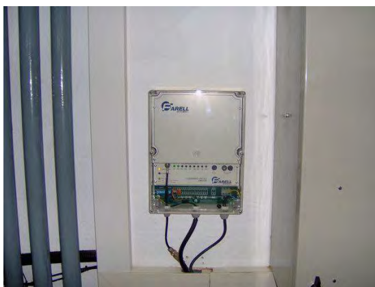
Vía Ràdio d'emergència
