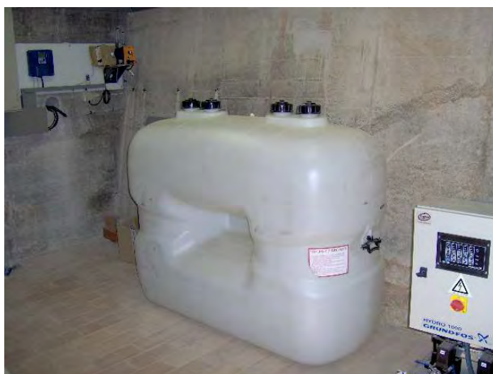
Dipòsit d'Hipoclorit Sòdic de l'estació del Puig d'en Roca
