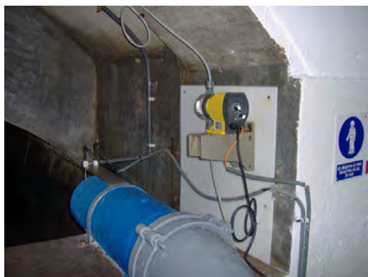
Dosificador de Hipoclorit Sòdic
