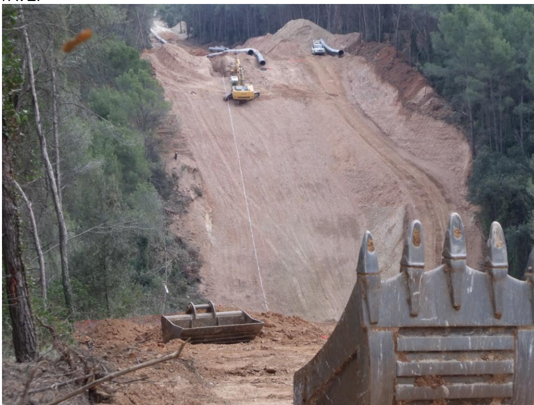
Imatge 2: fotografia presa durant la fase d'obres del primer tram a Castellar del Vallès.
